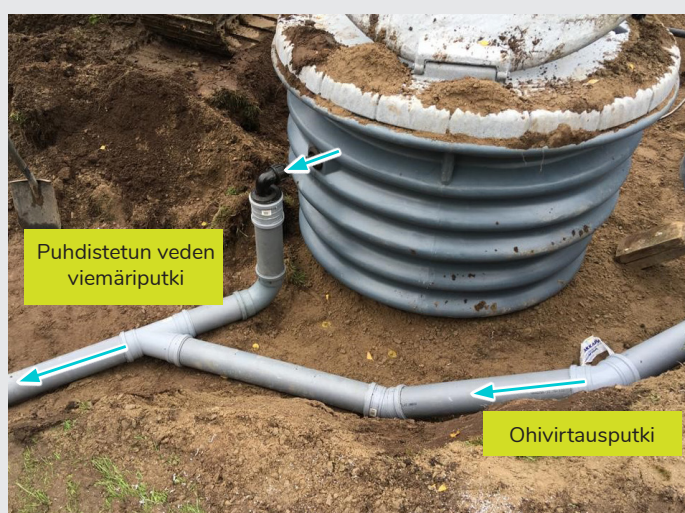
Kuva 20: Ohivirtausputki ja puhdistetun veden viemäriputki
